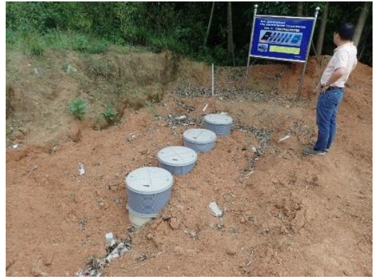
試験的に導入された合併浄化槽
